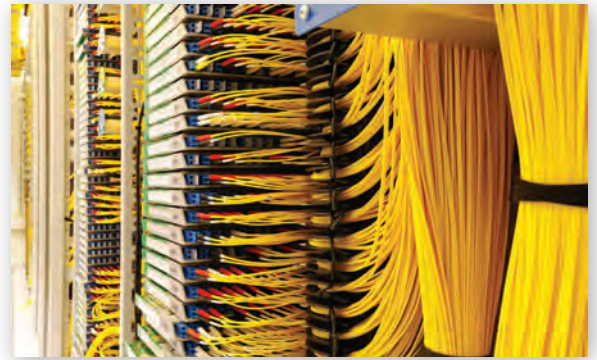
Рис. 11. Кабели и кабельные жгуты, проложенные в помещении
