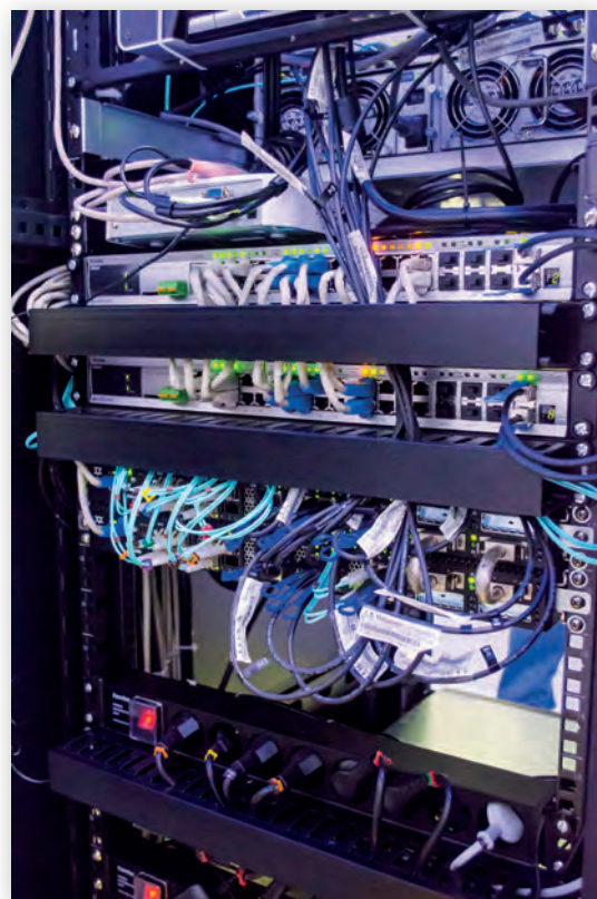
Вид на стойку с СХД со стороны коммутационных панелей
